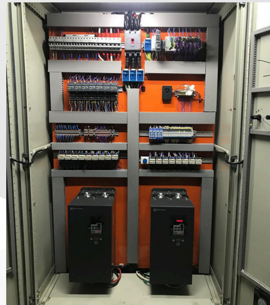
Painel para acionamento e automação de exaustores industriais.
