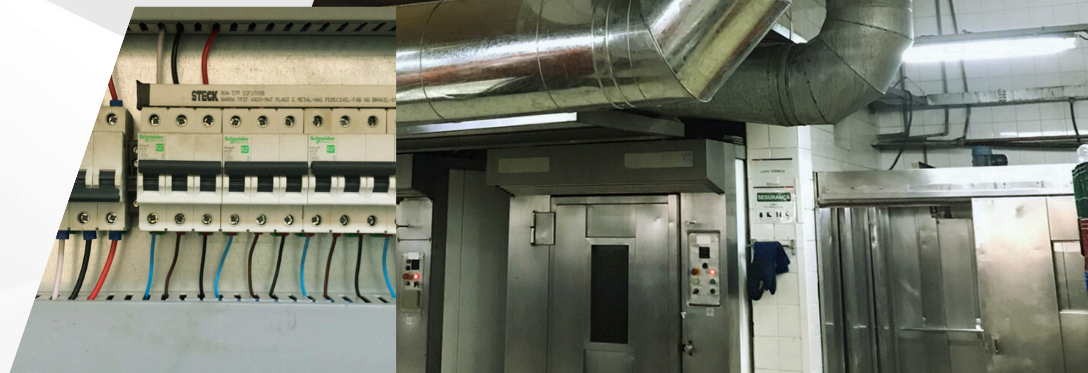
Projeto e Instalação de Sistema de Exaustão e Ventilação para confeitaria industrial.
