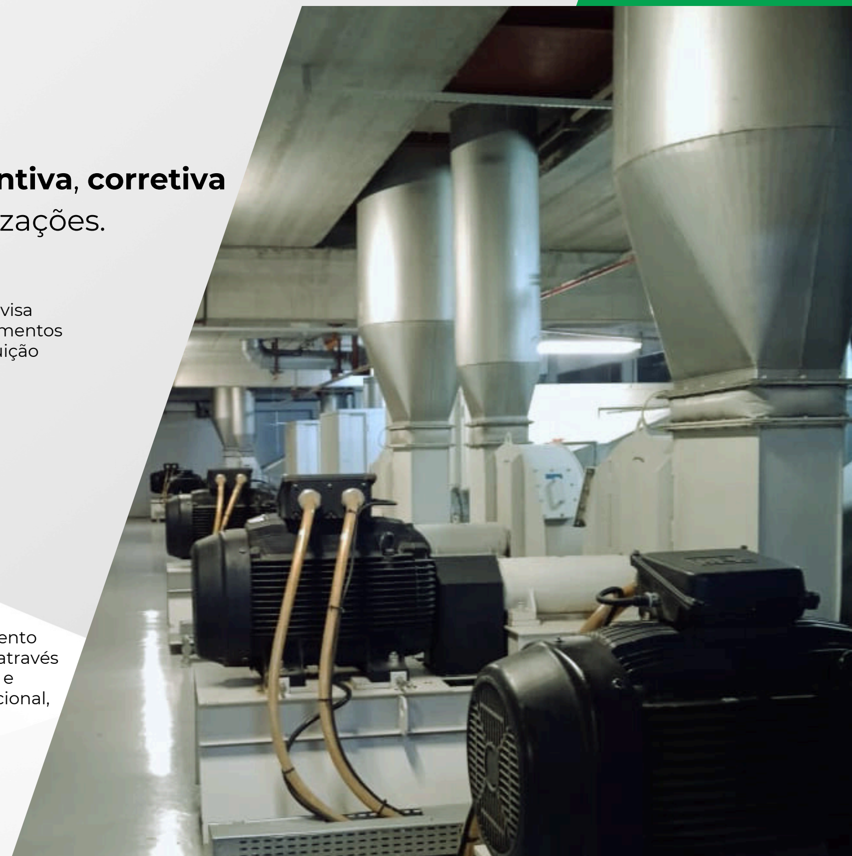
Manutenção Preventiva e Corretiva no Sistema de Ventilação Industrial
